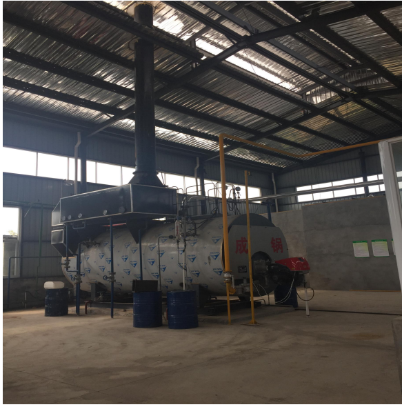
蒸汽锅炉排气筒
