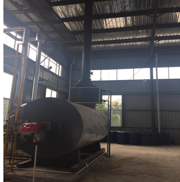
导热油锅炉排气筒
